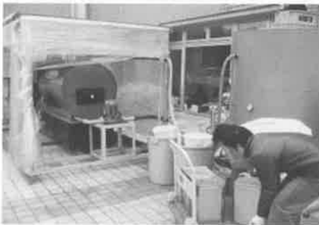
【写真1】温泉施設での木質バイオマスボイラー
